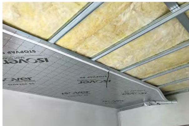
Šikmá strecha - tepelná izolácia zo sklenených vlákien
