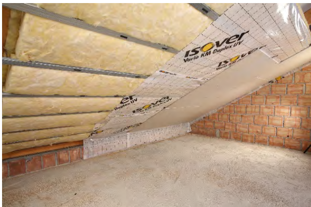
Šikmá strecha - tepelná izolácia zo sklenených vlákien
